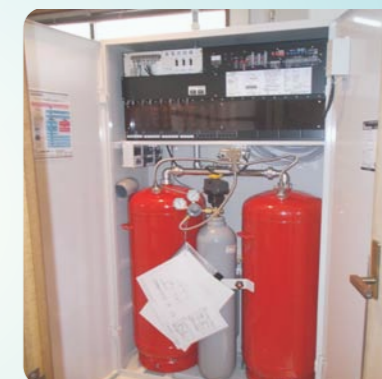
パッケージ型自動消火設備
