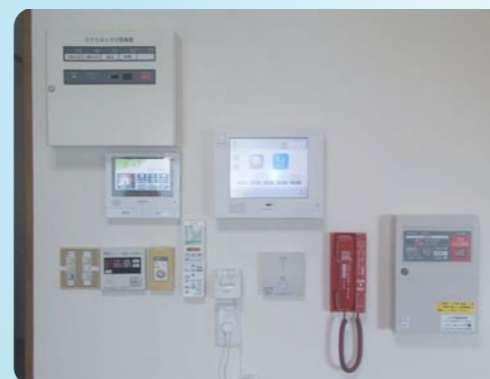
自動火災通報装置
