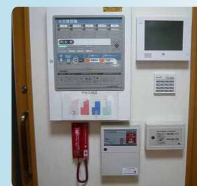
自動火災通報装置
